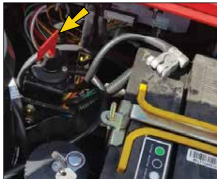
شکل ۴۴: کلید قطع کن باتری
